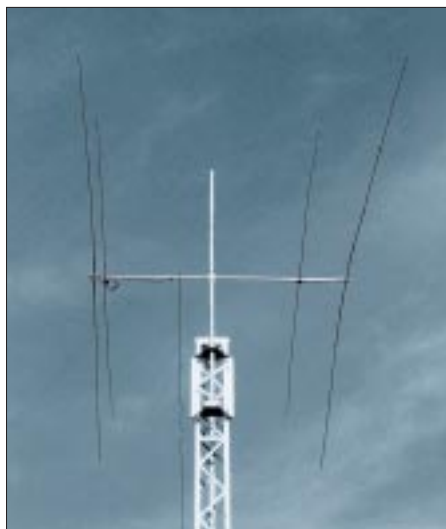
Bild 1: Die fertig aufgebaute Antenne auf einem Gittermast mit Schlitzen
